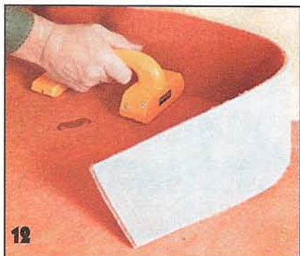
12 Резак с лезвиями и двумя прижимными колодками используют при обрезке у стены толстых ковровых покрытий.
