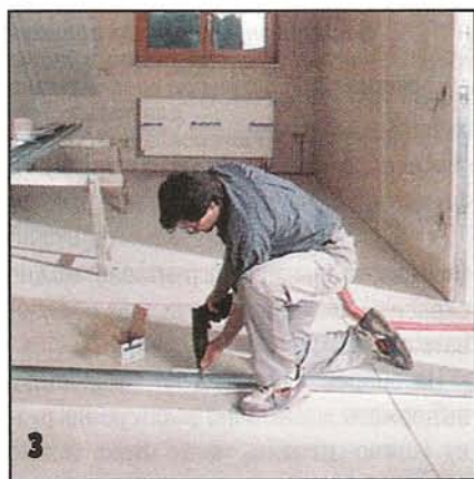
Каркас крепят к полу шурупами сквозь отверстия, просверленные на тыльной стороне профилей на шаг примерно 70 см.
